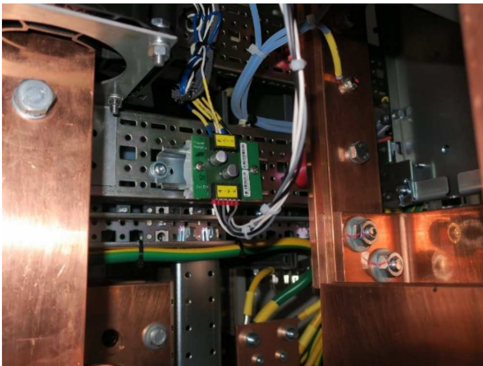
Bild 18: Fertig montierte Kondensatorplatine D004-A6 im Einspeisefeld +1S3
