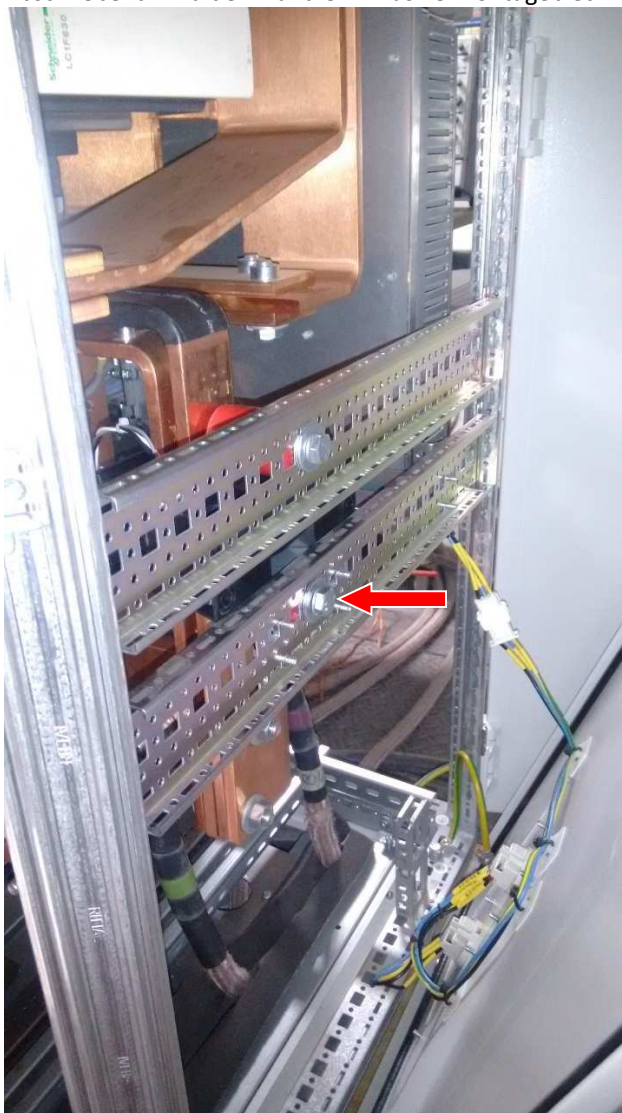
Bild 10: Einspeisefeld +1S3 mit abgeschraubter und zur Seite gelegter Gehäusewand, Der Pfeil zeigt die M10-Befestigungs-schraube des unteren Sammelschienen-Stützers der Statorphase V.
